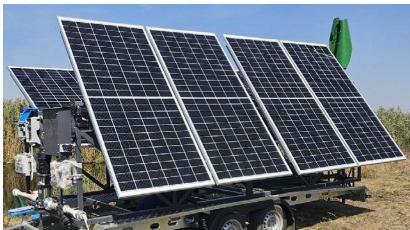
Fig. 2. Cadru cu panouri fotovoltaice
